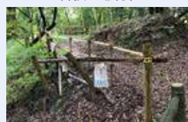
防護柵の老朽化
